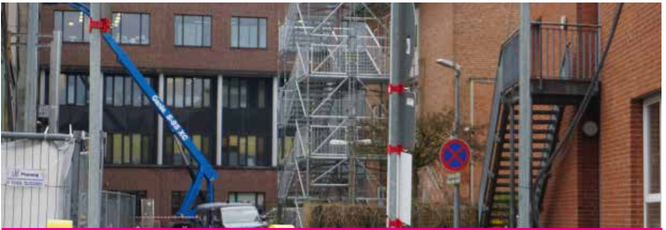
Ein vertrauter Weg verschwindet: Die Brücke zwischen Kinderklinik und Haupthaus wurde kürzlich zurückgebaut. Neu entstanden ist die neue Fluchttreppe an der Kinderklinik rechts im Bild.
